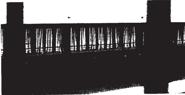
A paliçada pedonal de acesso já se encontra em processo de degradação
